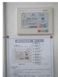
↑ スプリンクラーの制御盤
