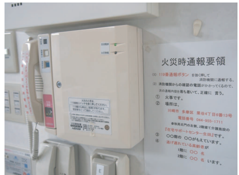
火災を感知すると消防署へ自動通報するシステム
