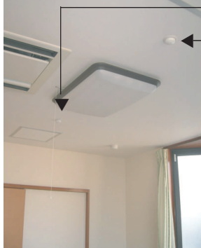
各居室に2カ所ずつ設置されたスプリンクラー(矢印)。
